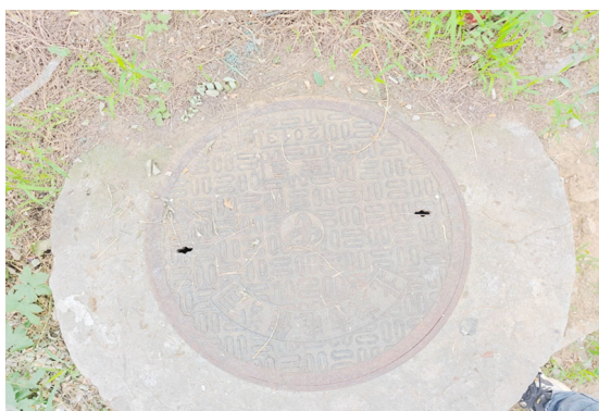
项目内通讯检修井
