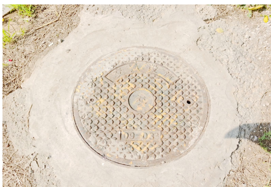
项目内电力检修井
